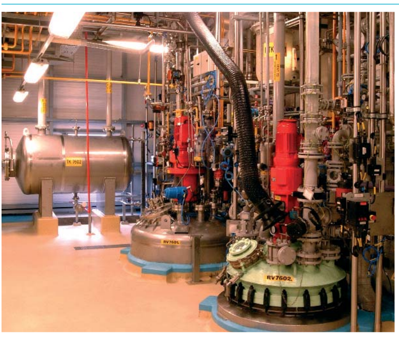
爱尔兰共和国API化学工厂的反应堆大厅
